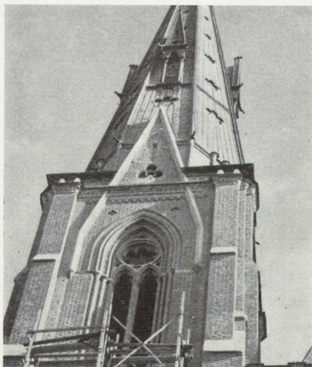
Norra tornets nuvarande utseende vid övergången mellan tornkropp och spira, sedan skyddsarbetena genom de sakkunnigas ingripande begränsats.
